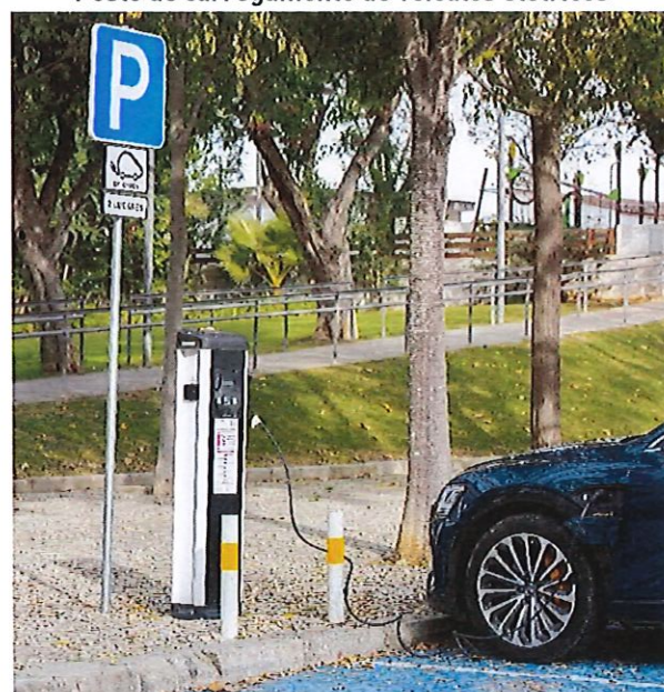
Posto de carregamento de veículos elétricos
